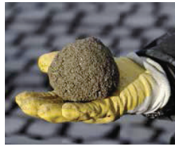
Die optimale Konsistenz ist dann erreicht, wenn der Drain-Bettungsmörtel sich zu einer Kugel formen lässt
